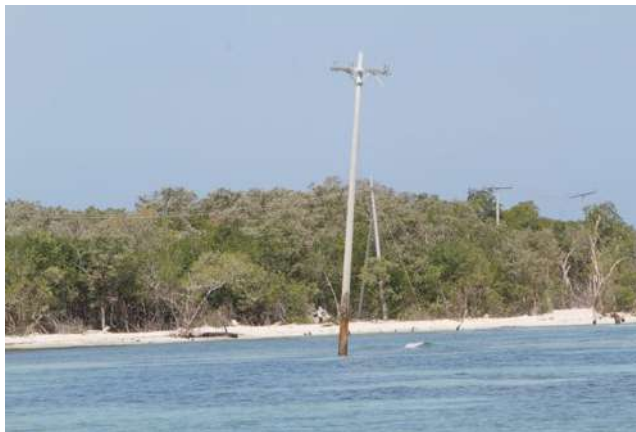
Figura 126. Infraestructura de energía afectada por erosión costera en Playetas (Barú)
