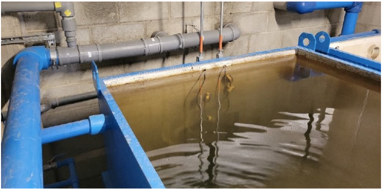
Foto 10. Tanques de agua lluvia. Créditos Green Loop
